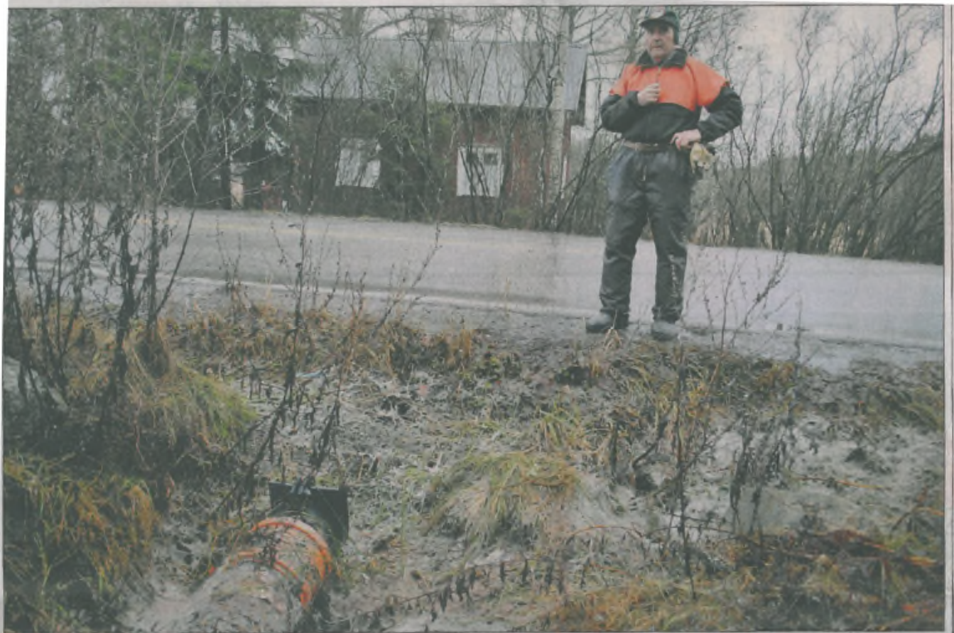
Ojassa näkyy yhä perjantaisen ylijooksutuksen jäänteet. Haju on sen mukainen. Toivon, että tämä putki siirretään, Kalevi Hietala sanoo. Hänen mökkinsä näkyy taustalla.
